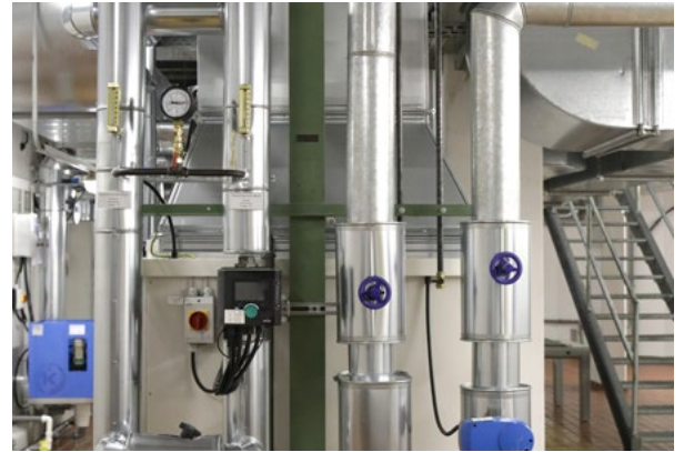
Während der Modernisierung der Gebäudeautomation arbeitete das Rechenzentrum ununterbrochen, ohne Ausfälle. (Bild: Johnson Controls / Bildschön)
