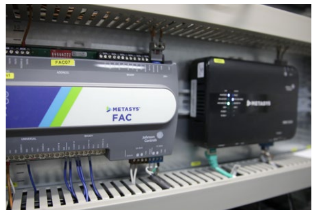
Neben den Automationsstationen vom TYP SNE wurden im Rechenzentrum insbesondere neue Anlagenregler vom TYP CGM und FAC implementiert – bei laufendem Betrieb. (Bild: Johnson Controls / Bildschön)
