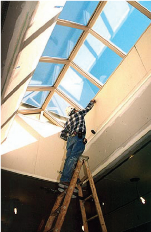
ウェッジ1のカフェテリアにある天窓がペンタゴンの従業員に自然光を注ぐ
